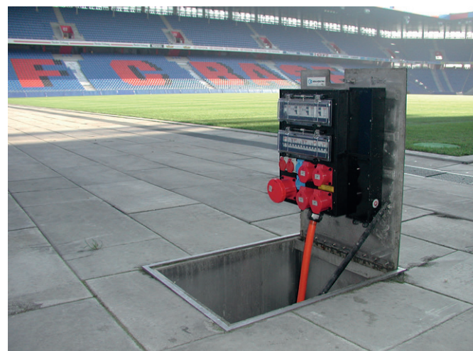
Distribution électrique souterraine, Parc St-Jacques, Bâle
